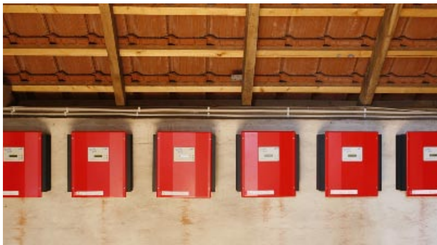
Wechselrichter sollten möglichst nicht direkt unter der Dachhaut installiert werden, weil es dort im Sommer sehr heiß werden kann. Fotos: Einhoff (4), Heil
