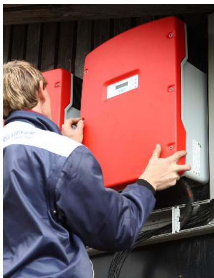
Defekte Wechselrichter sollten vom Hersteller innerhalb kürzester Zeit ausgetauscht werden.
