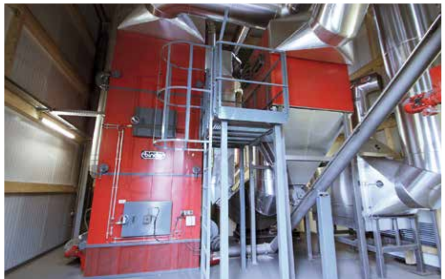
Der 3 MW-Hackgutkessel von Binder wird ohne Pufferspeicher betrieben.
