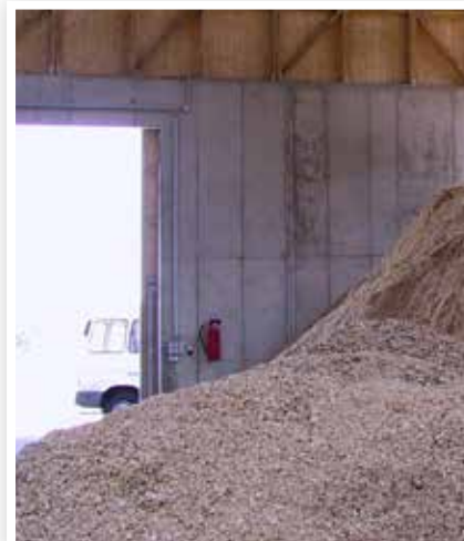
Lagerraum für Hackschnitzel
