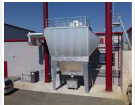
5.000-kW-Heizwerk zur Prozesswärmeversorgung
