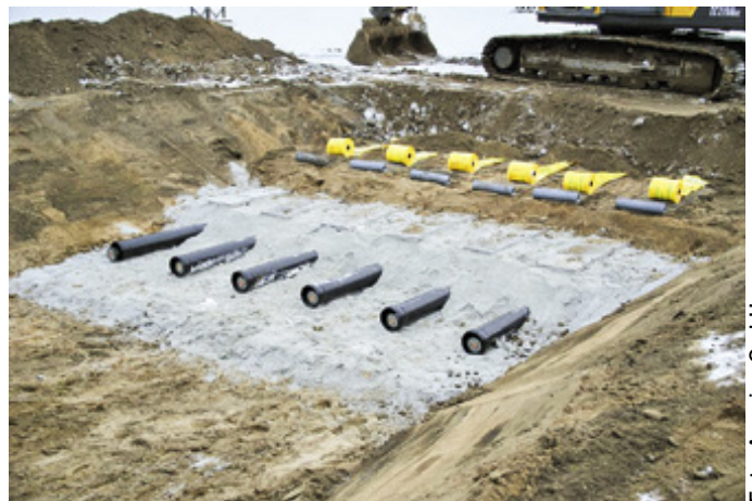
Foto: Amprion GmbH
