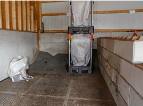
△ Die Trocknungsboxen sind befahrbar und mit mobilen Betonsteinen abgetrennt.
